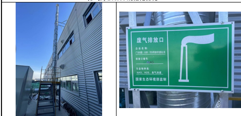
排气筒 DA003 规范化情况
