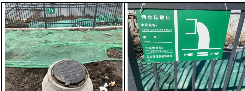
厂区废水总排口及规范化情况
