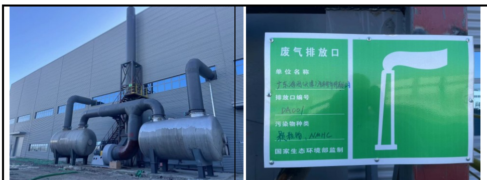
排气筒 DA001 规范化情况
