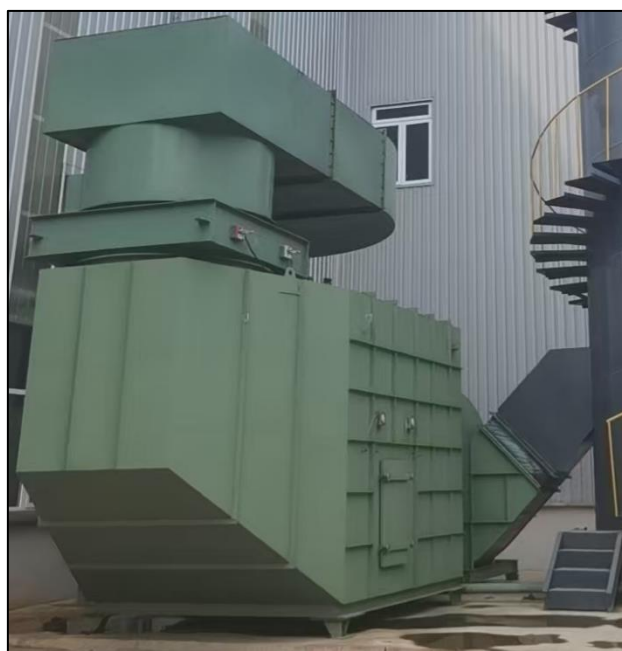
图 3-1 废气处理设施实际建设情况图
