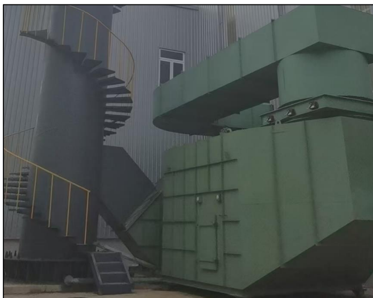
图 3-1 废气处理设施实际建设情况图
